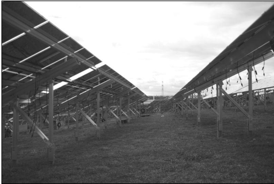
Abbildung 7 PV-Anlage (First Solar) auf der Deponie Flörsheim-Wicker, Erweiterung im Jahr 2010 auf 1.100 kWp
