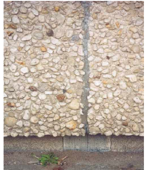
Dauerelastisch gedichtete Außenfuge mit „Thiokol“, bis 1972 mit PCB-Zusatz als Weichmacher
