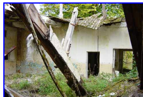
Fortschreitender Verfall der Gebäude
