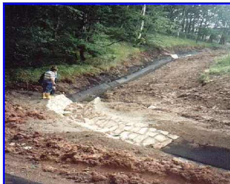
Maßnahmen zur Ableitung des Oberflächenwassers
