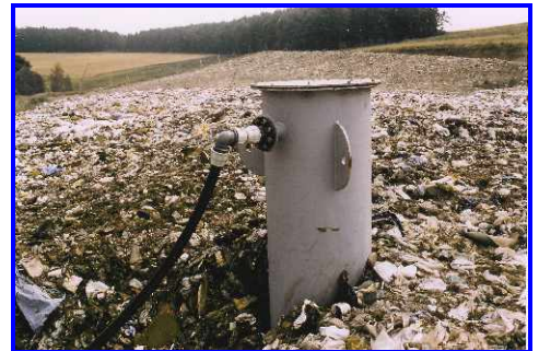
Vertikalbrunnen der Deponieentgasung
